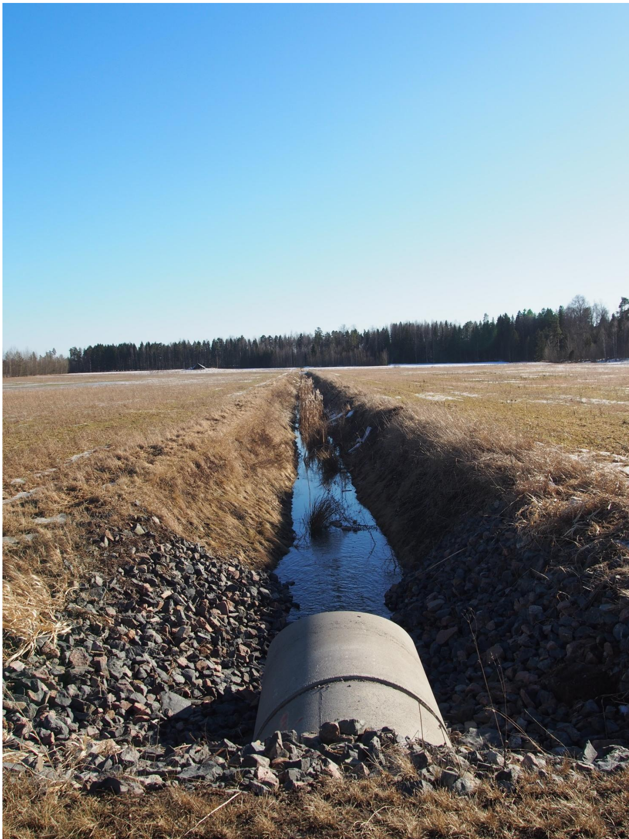
Kuva 10. Lepolan alueen hulevesialtaiden purkuputki. Valokuva kohti Räikilänojaa.
