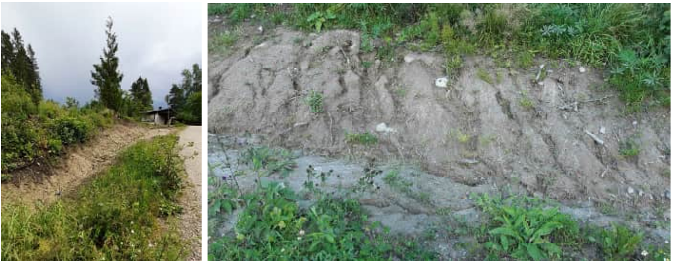
KUVAT 13 A JA B. ILMAN KASVILLISUUSPEITETTÄ OJAN LUISKAEROSIO ETENEE NOPEASTI JA VESI KULJETTAA IRTOAINESTA LOUTINOJAAN.
